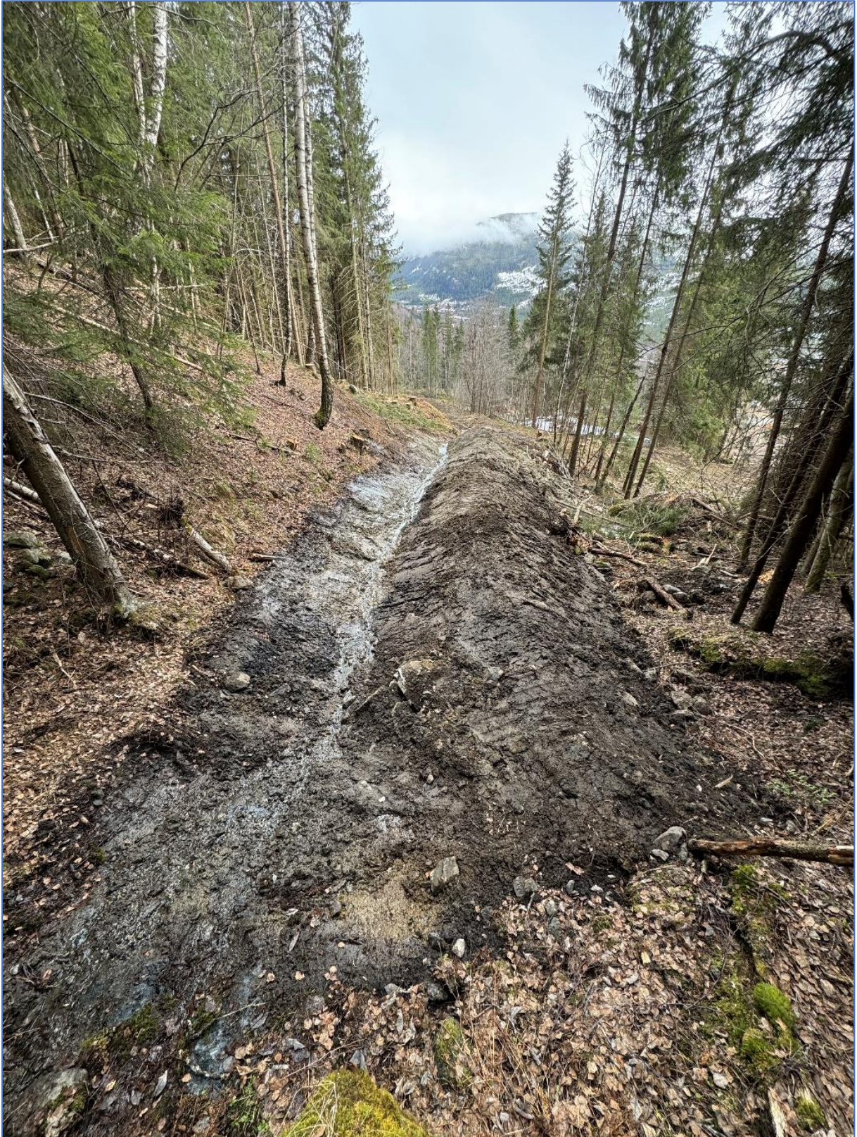
Figur 8: Bildet viser en lav voll/dreneringsgrøft med overhøyde ca. 0,5 -1 m like ovenfor Oppsatavegen 110
