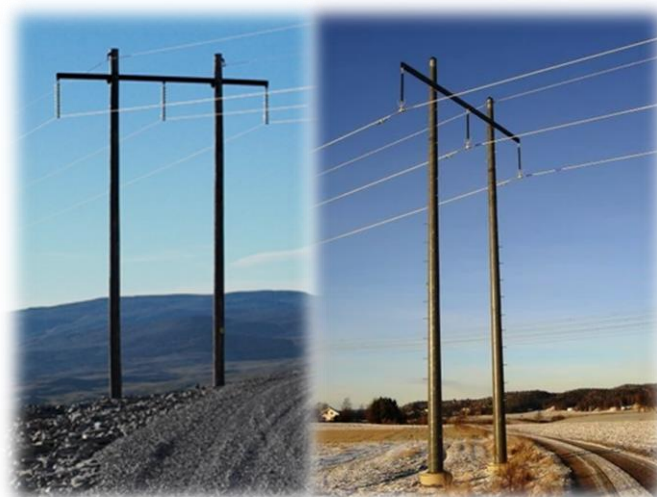
Figur 10 Eksempel på tremast til venstre, og komposittmast fra Melbye.no til høyre
