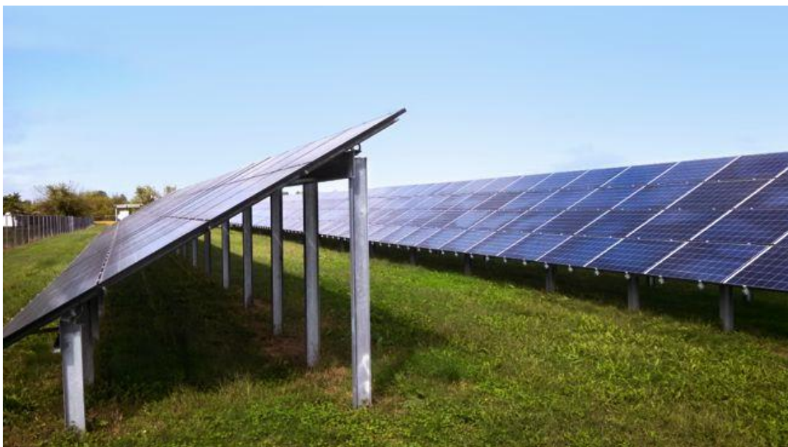
Figur 3-3: Eksempel på fast-vinkel installasjonsløsning (foto: Willowbrook Solar)
