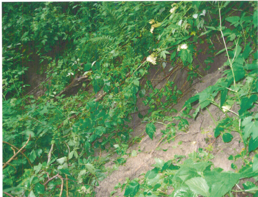
Figur 2 Terrenget har sprukket opp og sunket ned i skråningen nedenfor Linjeveien 13. Bilde tatt 9. juli 2007.
