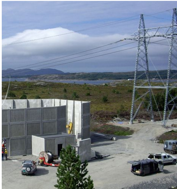
Figur 13 Eksempelbilde muffesjakt (avslutning 420 kV kabel)
