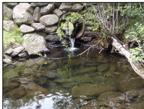
Bilde 8: Løgga i kulvert under Løggestølvegen.
