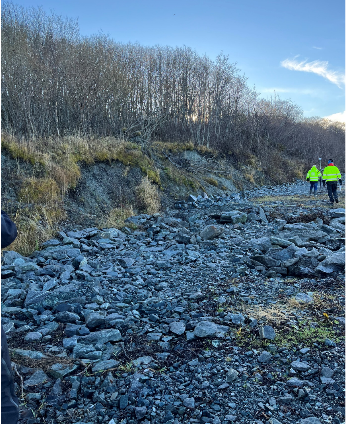
B7 - Retning mot sør. Erosjonssår ved tidligere ras i 1982
