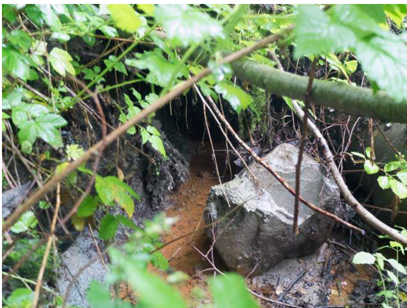
Figur 5: Rør på høyre side av betongrør ved P0.
