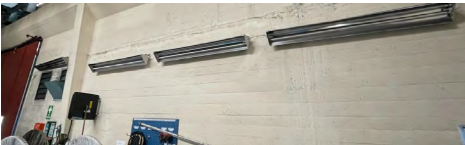
Bilde 3 Lysarmatur i maskinsal.
