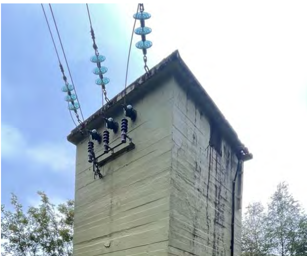
Figur 2 Kabel gjennomføring i trafotårn.
