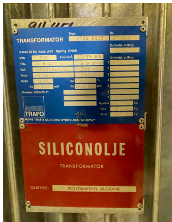
Figur 1: Typeskilt på stasjonstrafo
