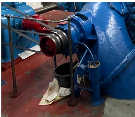
Bilde 1 Maskin med tydelig oljelekkasje fra aksling.
