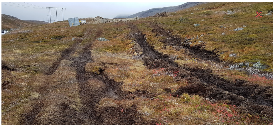
Figur 8: Når det etableres et nytt kjørespor, skal dette benyttes. Entreprenør skal terrengforsterke fremfor å etablere parallelle spor.
