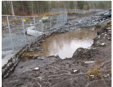
Figur 44: Enkelt sedimentasjonsbasseng for oppsamling av sand og gruspartikler. Viktig at de blir tomt regelmessig, for å opprettholde funksjonen.
