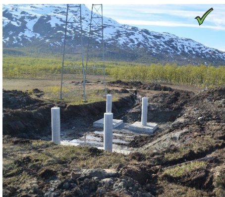
Figur 17: Godt eksempel på at vegetasjonslaget er tatt vare på, for bruk til istandsetting.
