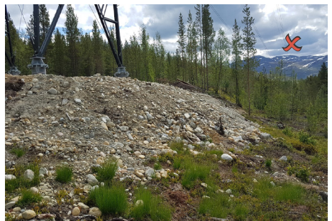
Figur 26: Vegetasjonsmasser er ikke lagt ut som topplag. Selv om det er et område med skrint jordsmonn, må det som er av vegetasjonsmasser tas vare på for istandsetting. Utplassering av vegetasjonsstuer ville ha brutt overflaten, og lagt grobunn for raskere naturlig revegetering.
