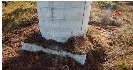
Figur 19: Ikke god overgang mellom stabbe og terreng. Massene oppå betongen vil tørke ut.
