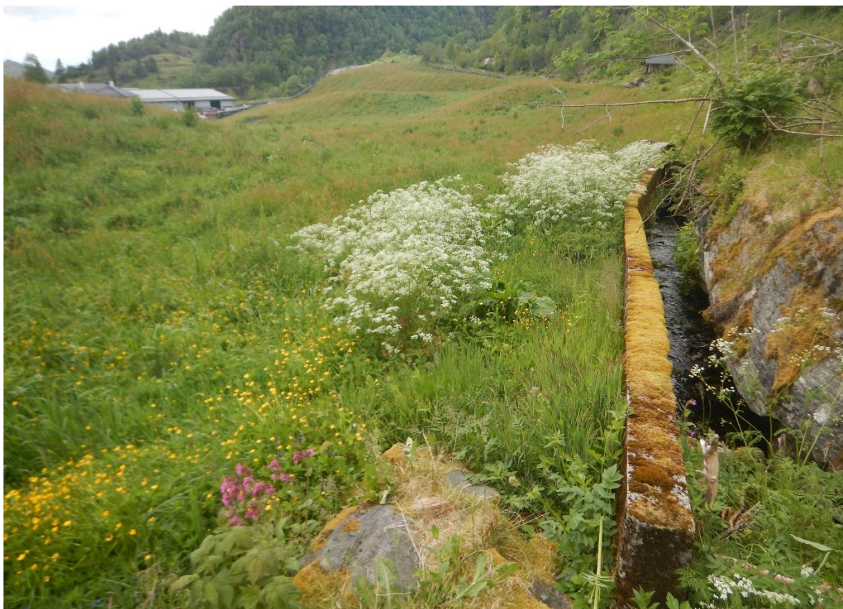
Figur 2: Bekken rett oppstrøms stikkrenne 1, og flomveien ned jordet til venstre.
