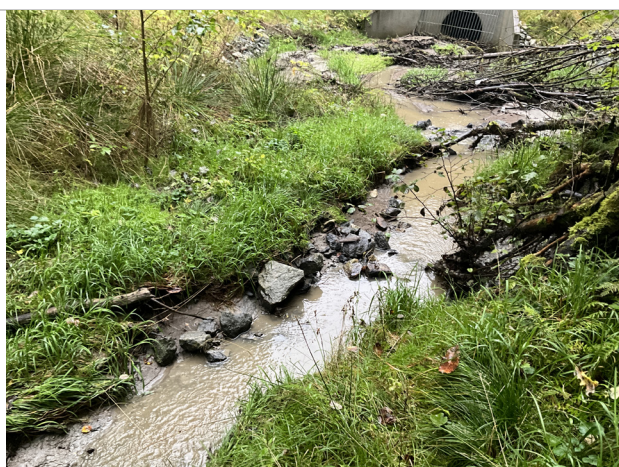
Bilde 9. Innløpet til kulverten er delvis plastret
