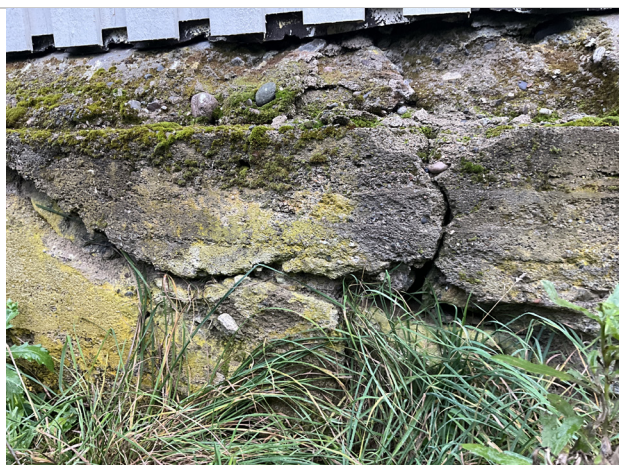
Bilde 13. Eldre sprekker i grunnmuren (Fjellboveien 19)
