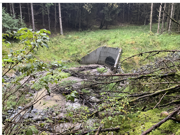
Bilde 10. Bekkelukkingen er delvis blokkert av sedimenter og vegetasjon. Meldt inn til SVV.
