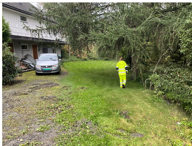
Bilde 12. Huseieren melder at skråningskanten er noen meter nærmere huset (Fjellboveien 21) enn for noen tiår siden
