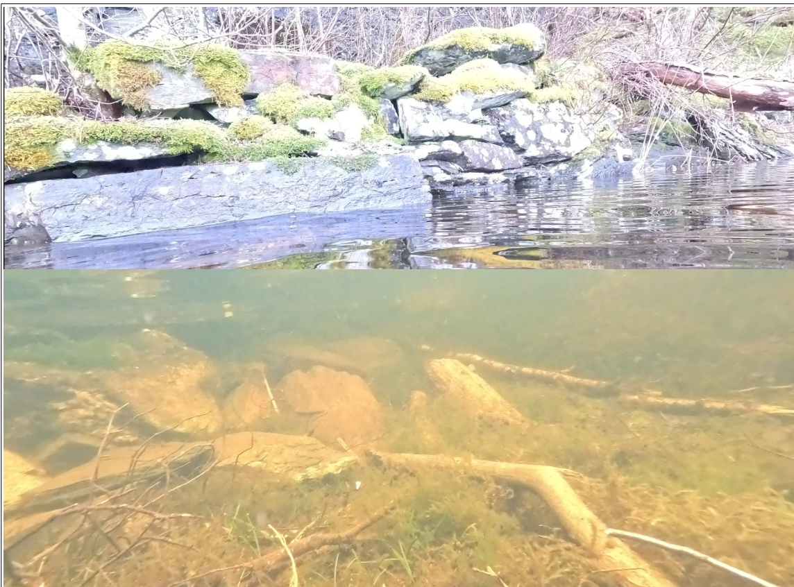
Figur 3: Nærbilde av kaien sett over og under vann. Utenfor er det grunt, og det ligger steiner som har falt ut av kaien.
