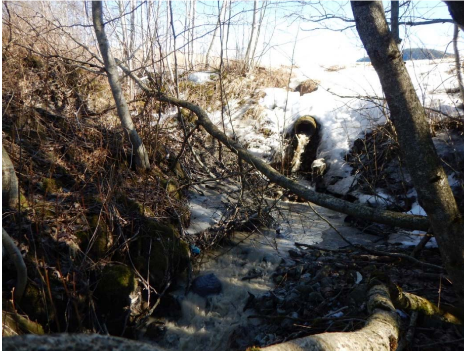
Figur 12: Utløp av rør
