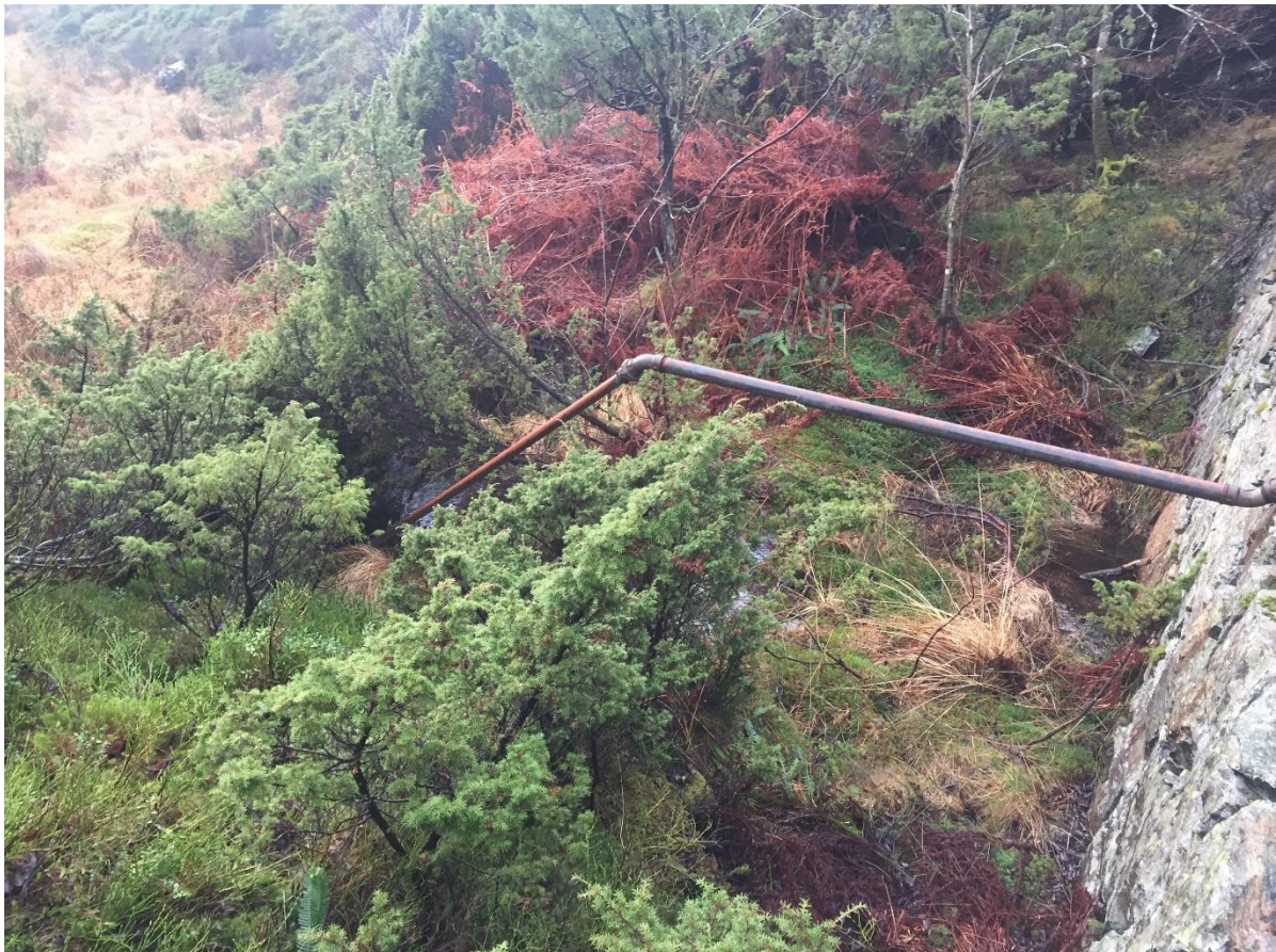
Bilde 4 Hoveddam Storavatn. Lekasje gjennom dam, samt gammelt rør over dam. Bilde viser nedstrøms side av dam. (09.12.16)
