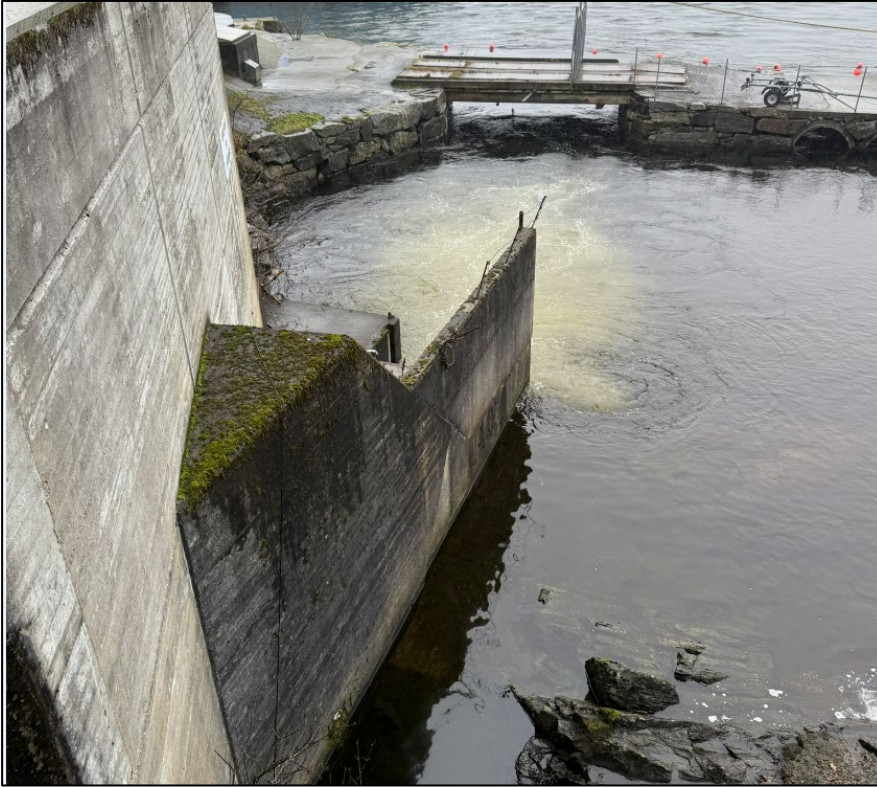
Figur 25: utløp stasjon (Foto: Småkraftkonsult)
