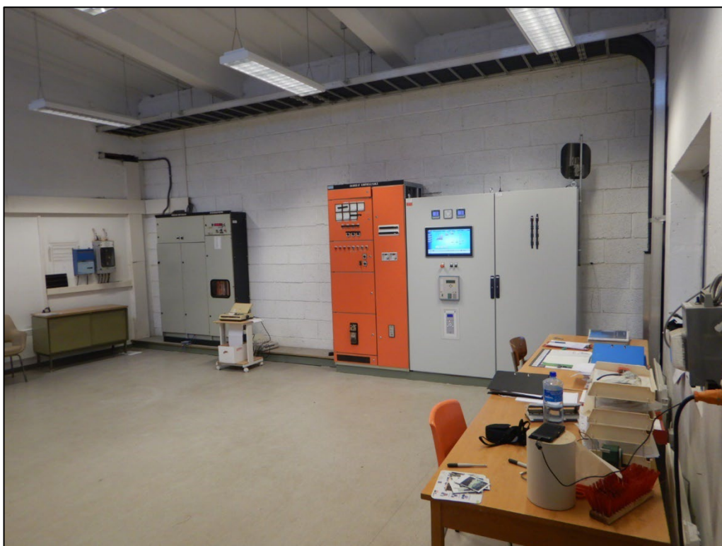
Figur 27: Kontrollrom stasjon (Foto: Småkraft)
