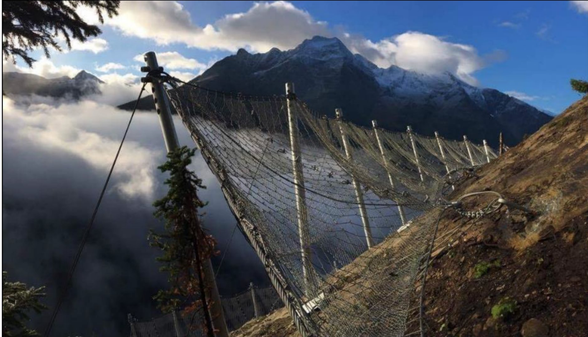
Figur 25: Eksempel på støtteforbygning i løsneområde for snøskred ( www.geobrugg.com ).
