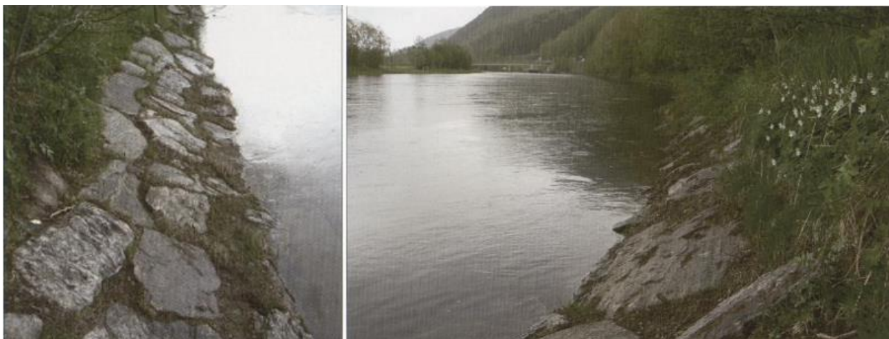
Figur 5-7. Elveforbygginger på sørsiden av Surna [9].
