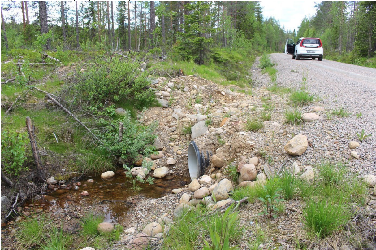
Figur 110 Eksempel på overfylt og kappet kulvert.
