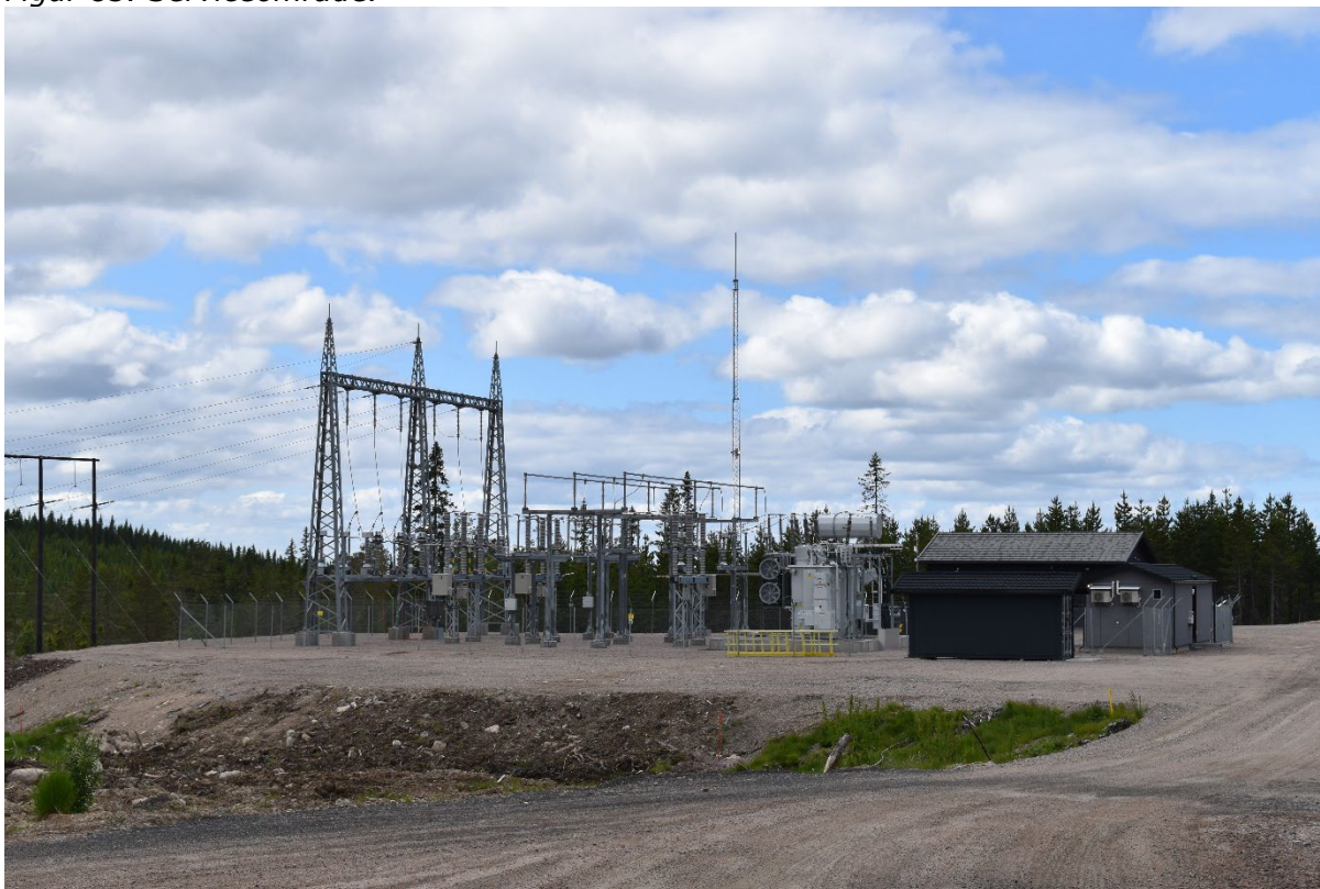
Figur 86. Koblingsstasjon med trafo, østside.
