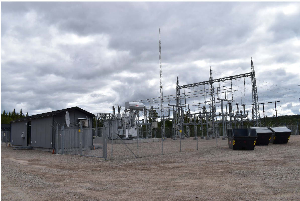
Figur 87. Koblingsstasjon med trafo, sett fra nord-vest.
