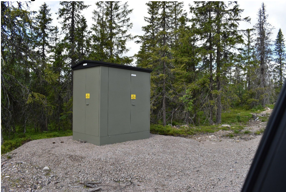
Figur 99. Koblingskiosk K05. Alle kioskene har lik farge og form.
