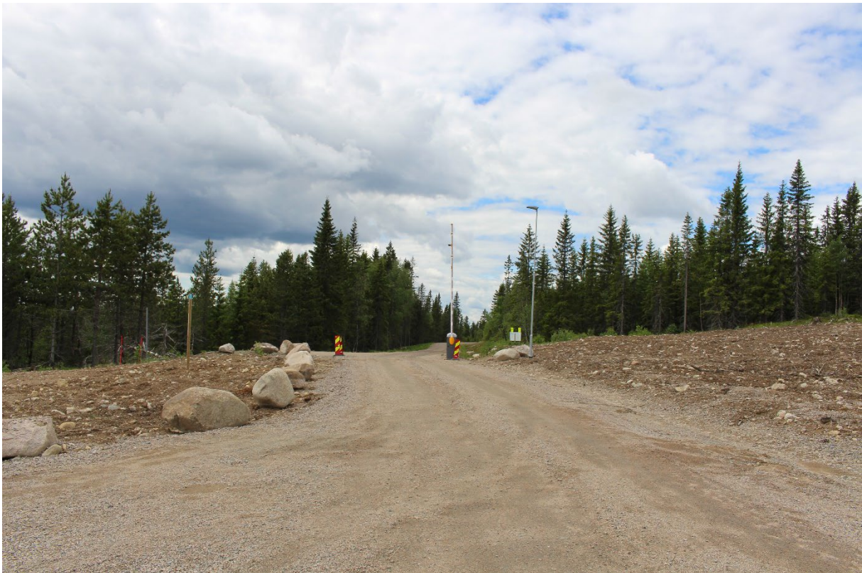
Figur 122. Ved serviceområdet er det oppsatt vegbom med elektrisk åpning og lukking.
