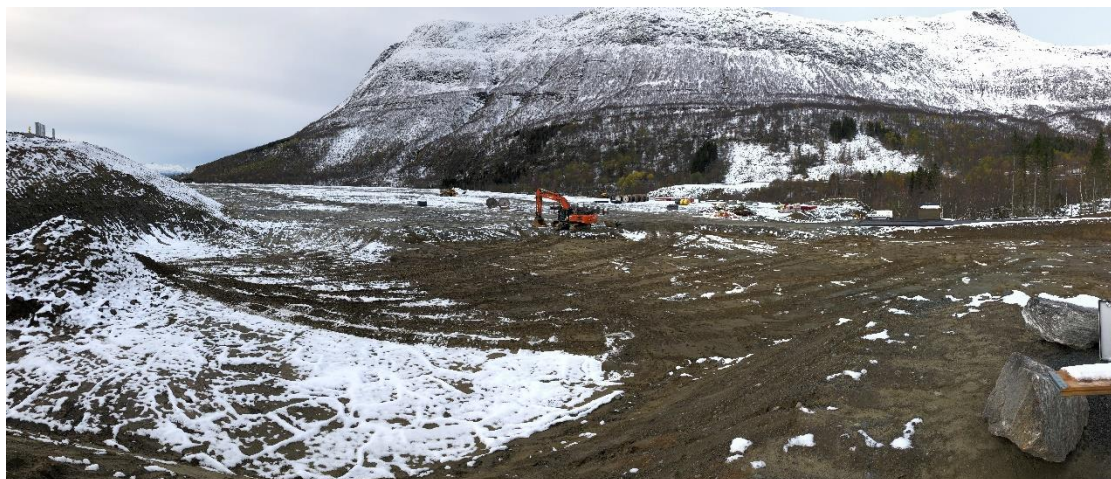
Figur 45. Bilde tatt nedstrøms av Skoglund 132 transformatorstasjon
