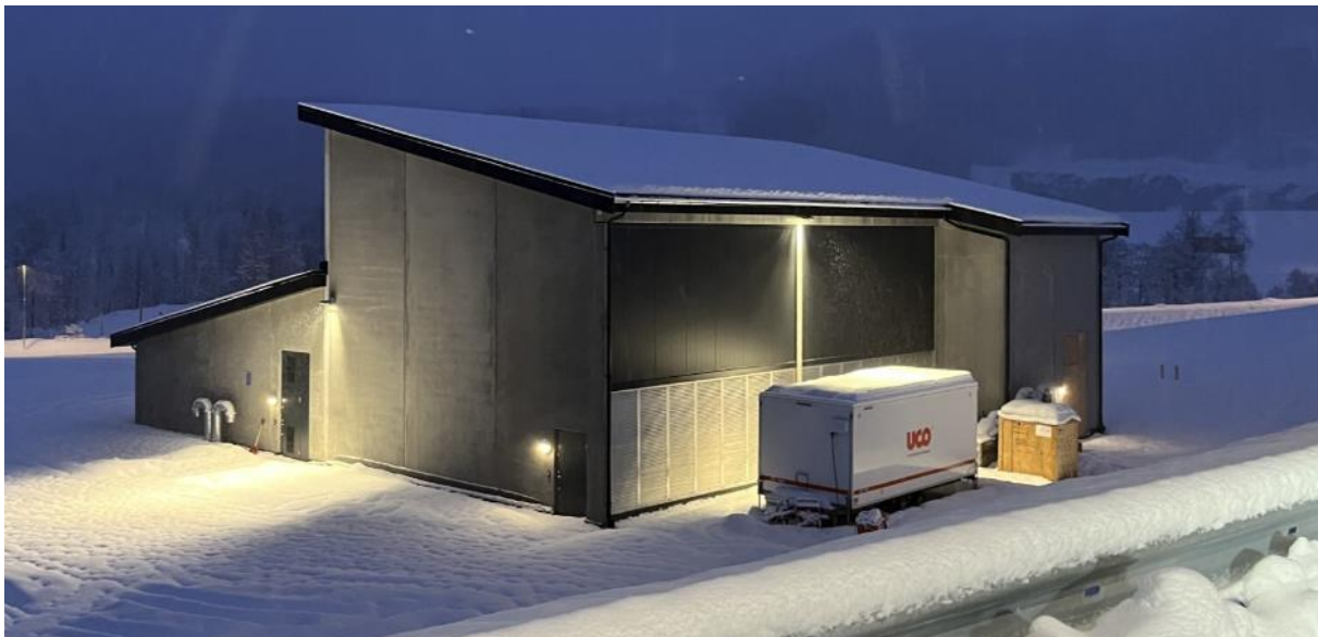
Figur 2. Skoglund 132 transformatorstasjon ferdig oppført og idriftssatt.
