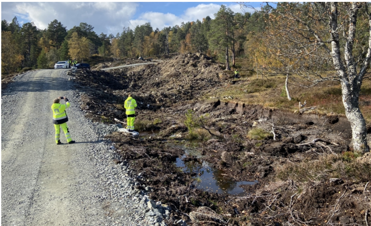
Figur 3: Endringssøknaden inkluderer beskrivelse av tiltak for å utbedre skader på et myrparti langs R9. Kilde: NVEs inspeksjonsrapport datert 3. oktober 2024 fra inspeksjonen 23.09.2024-25.09.2024.
