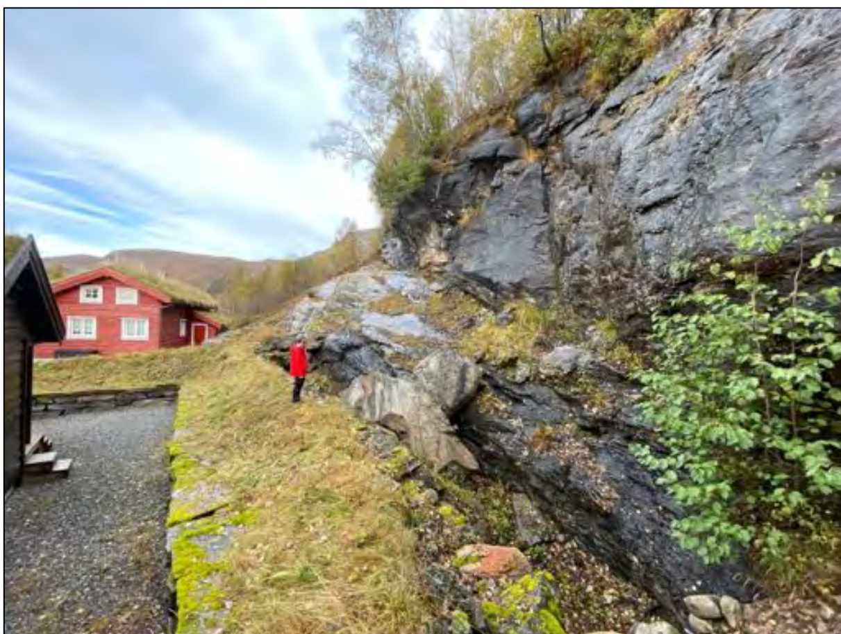
Figur 26: Bilde av en voll i bakkant av hytter sørøst i området hvor det har falt ned store bergpartier. Bildet er tatt mot nord.
