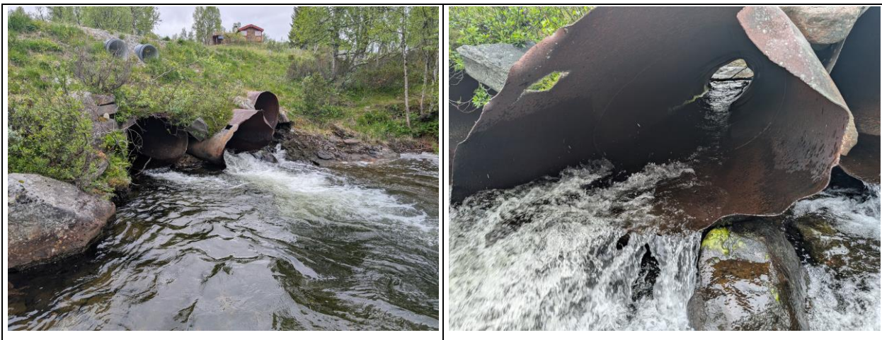
Figur 1: Kulvertene under veien Øystre Hedalsstølen var i dårlig forfatning. På lav vannføring kan disse bli temporære vandringshindre.
