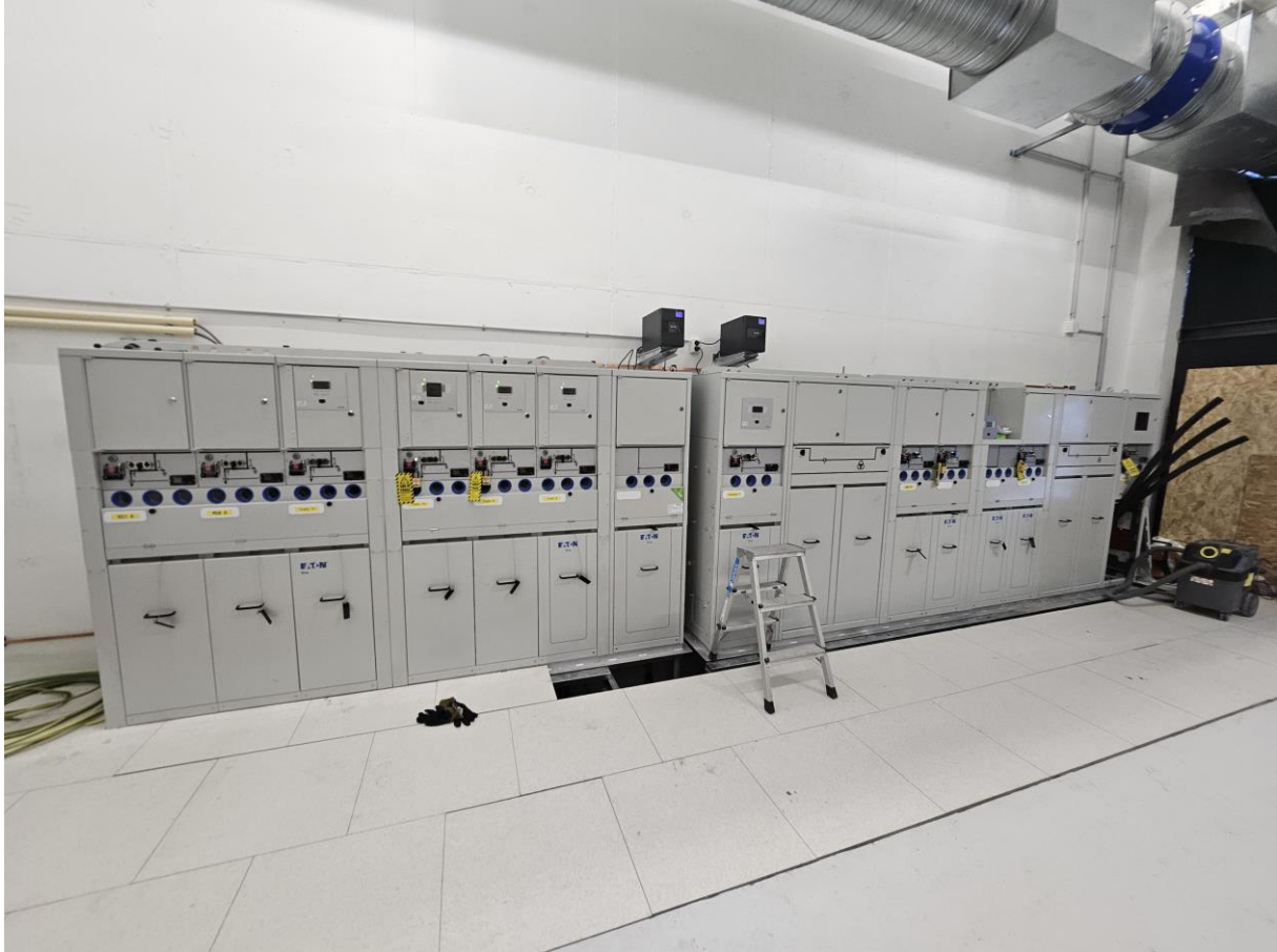
Figur 6: Bilde av anleggets hovedfordeling, lokalisert i nettstasjon 3.
