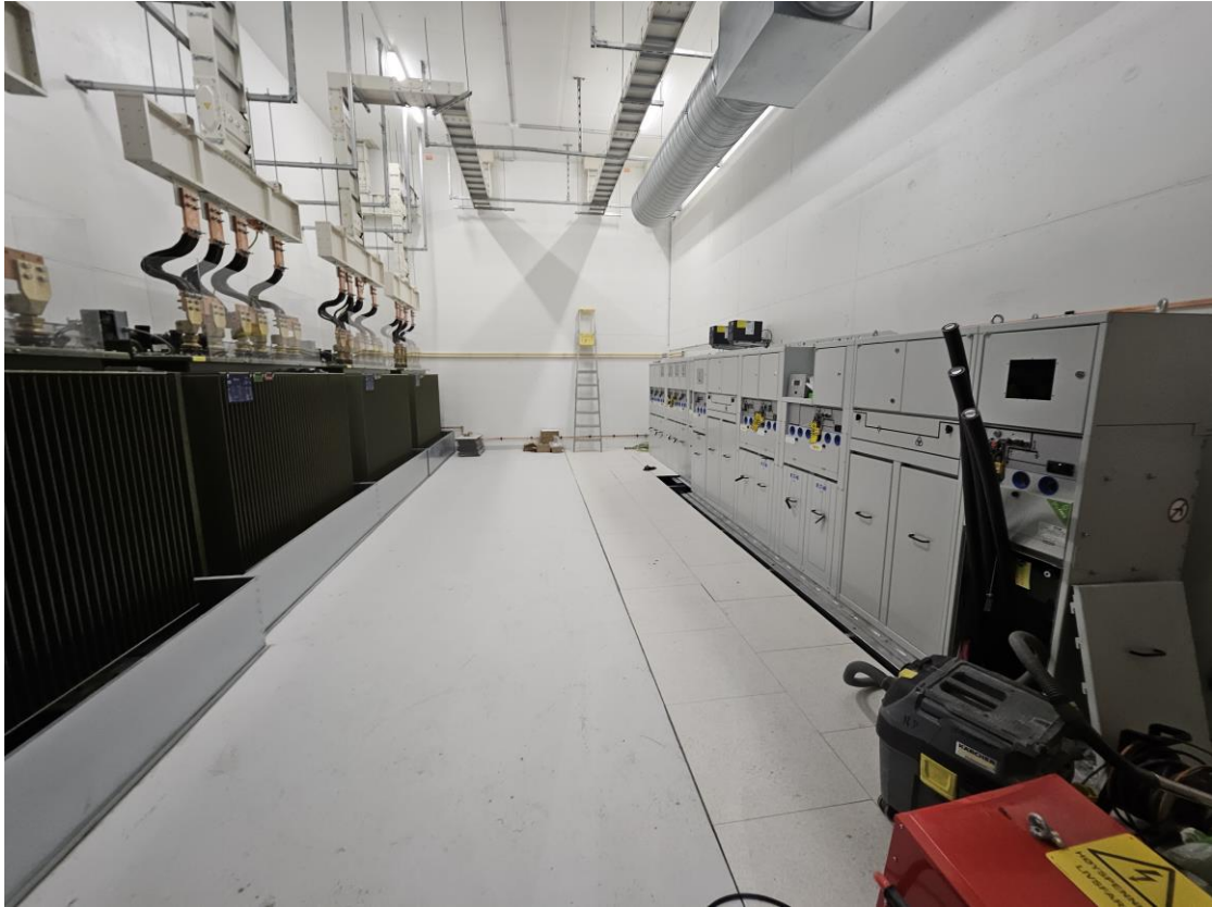
Figur 8: Bilde av fordelingsnett i nettstasjon 3.
