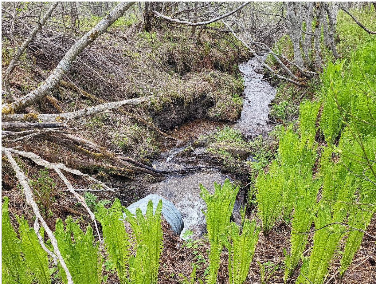
Figur 10: Erosjon/dannelse av bekkeløp nedstrøms stikkrenne, pr 1290. Foto: H. Lissman
