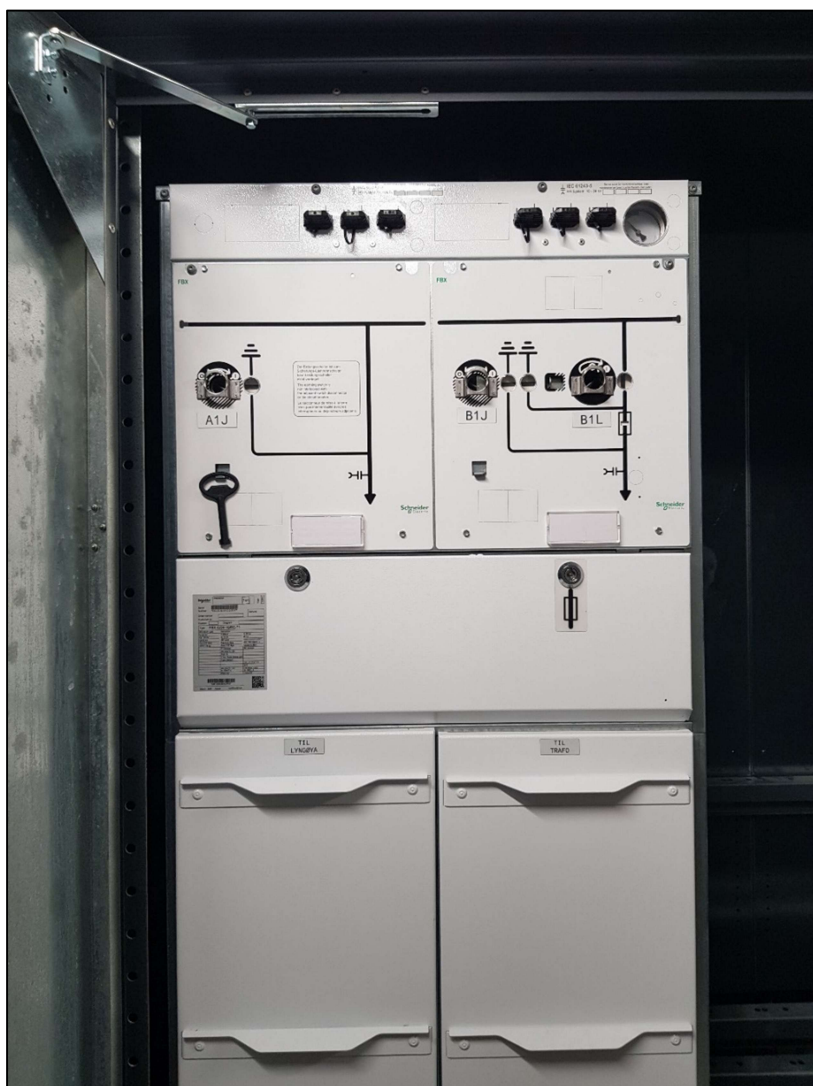
Figur 17 - Pre-fabrikkert nettstasjon om bord på alle oppdrettslokasjoner – åpen dør
