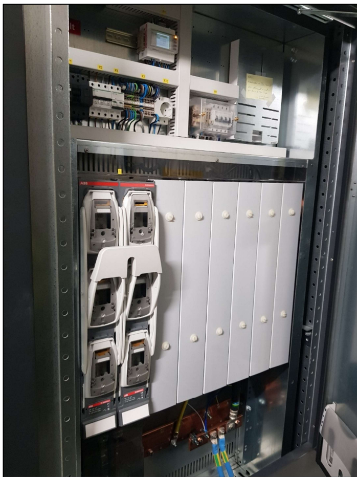
Figur 20 - Pre-fabrikkert nettstasjon lavspenavganger ombord Ruggstein tilsvarende på Rataren og Ørnøya
