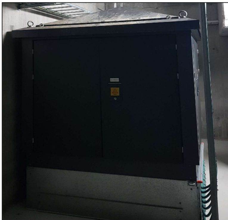
Figur 19 - Pre-fabrikkert nettstasjon - høyspentdør
