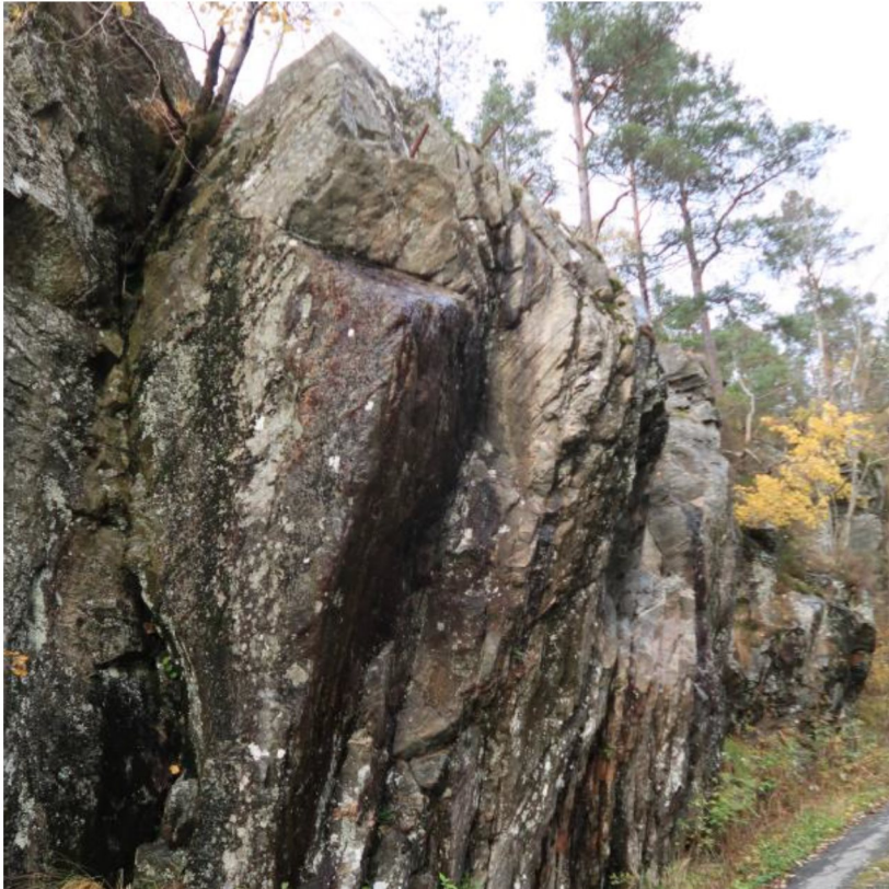
Bilde 1. Skjæring langs tilkomstveg med fare for nedfall.
