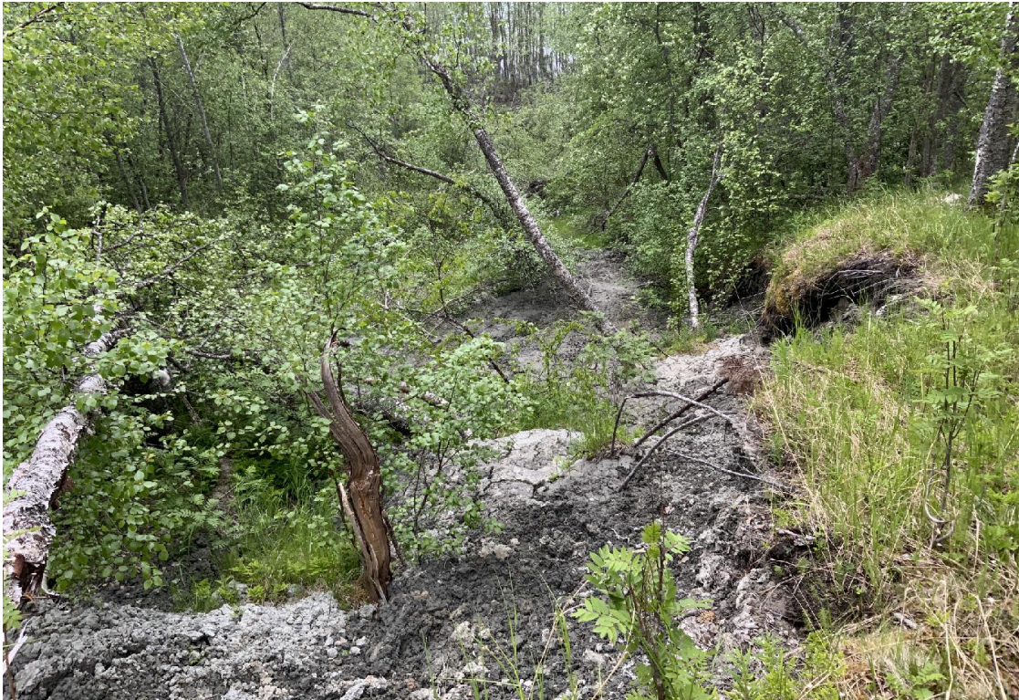
Figur 4-2: Ved profil 1 er det tegn til at vann strømmet ut av grunnen
