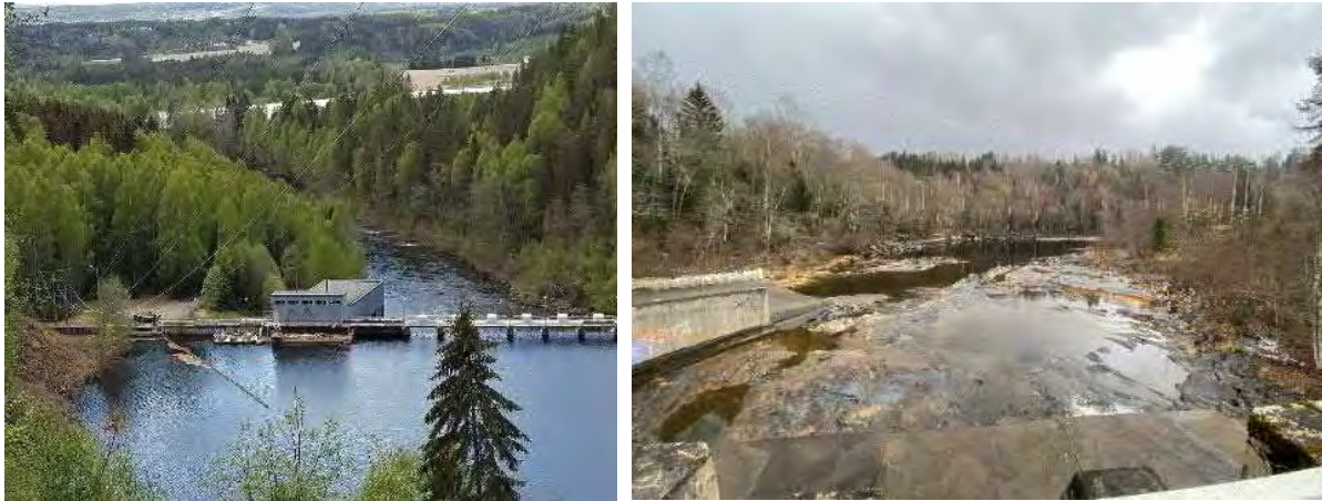
Figur 11-2. Venstre bilde viser Viuldammen med 17,5 m fall. Høyre bilde er tatt fra Løkkadammen og viser betongkanten av damfoten og litt av elveløpet nedover. Foto: Sweco Norge.
