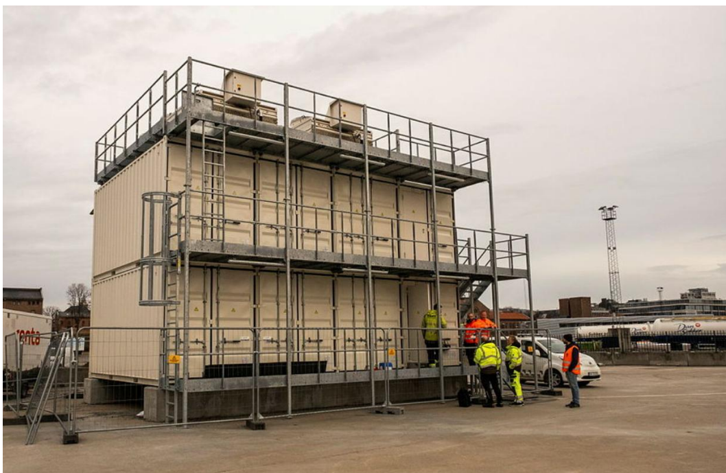
Figur 2 Bilde av tilsvarende type landstrøm anlegg for cruiseskip på Revierkaia
