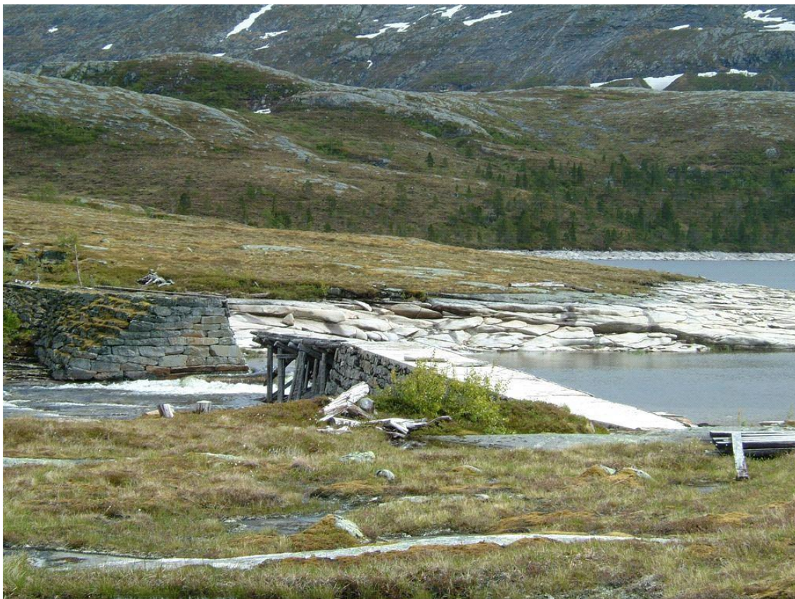
Figur 1-2 Dammen ved Mellavatnet. Midtpartiet er delvis revet, og vannstanden er på naturlig vannstand. 0-alternativet er å snevre inn midtpartiet til 1,2 meter. Vannspeilet vil med en slik løsning svinge mellom naturlig vannstand og topp dam avhengig av tilsig.
