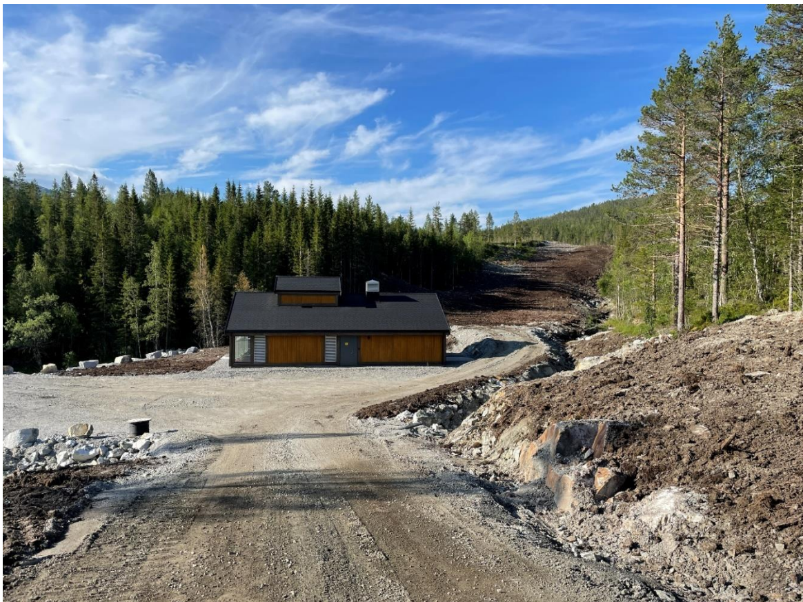
Hellifossen kraftverk - vannuttak fra trykrøret blir på baksiden av bygget
