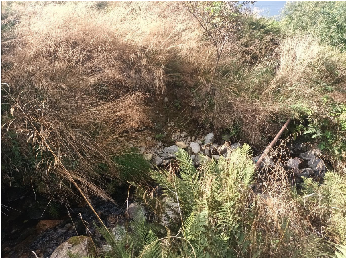
Figur 20: Tegn til erosjon i yttersvingen like nedstrøms for bro B2.
