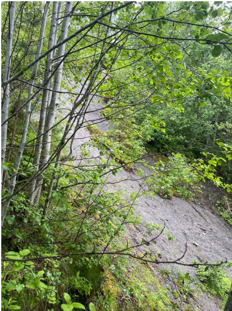
Figur 7. Skredmark i finkornet substrat i den bratte lia på østsiden av elva i nedre deler, ved Brattstiskulen. Foto: Geir Gaarder
