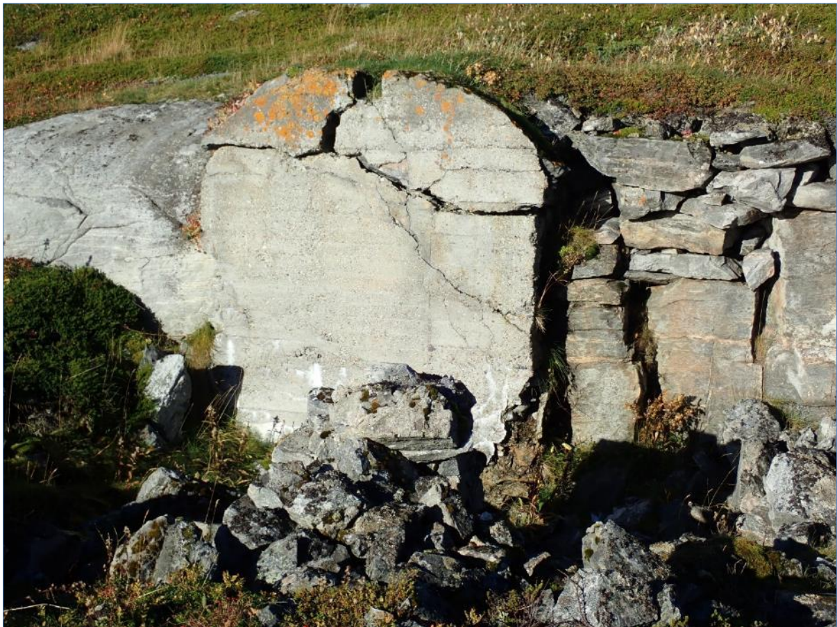
Figur 5-45. Melkøyneset. Betongplate murt mot bergvegg. Sans. endeveggen av en bygning (nr.12). Foto: NIKU 2020
