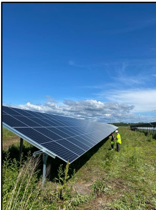
Figur 7: Bildeeksempel fra Solgrids 4,8 MW PV-anlegg i Varberg, Sverige.
