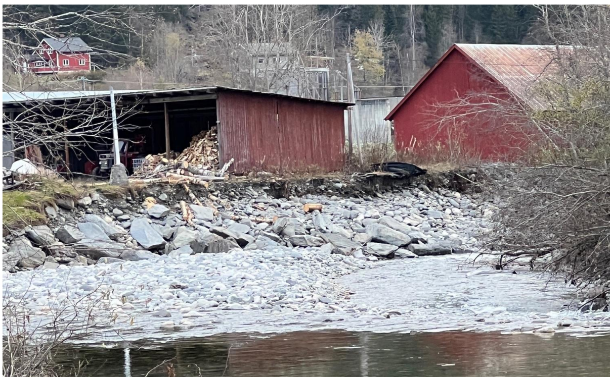
Figur 2-11. Bilde av skråning med erosjonssikring som ble påført skade under ekstremværet "Hans". Bilde: Jon Sylte
