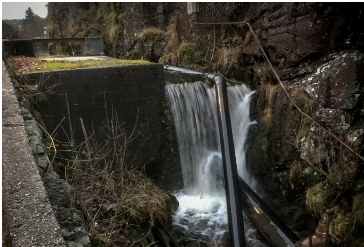
Dammen i utløpet av Storavatnet er vel 2m høy. De to inntaksledningene til anlegget i Tveitevågen er på 400 mm gjennom dammen og 250 mm over dammen. Det lekker 1-2 l/s gjennom.
