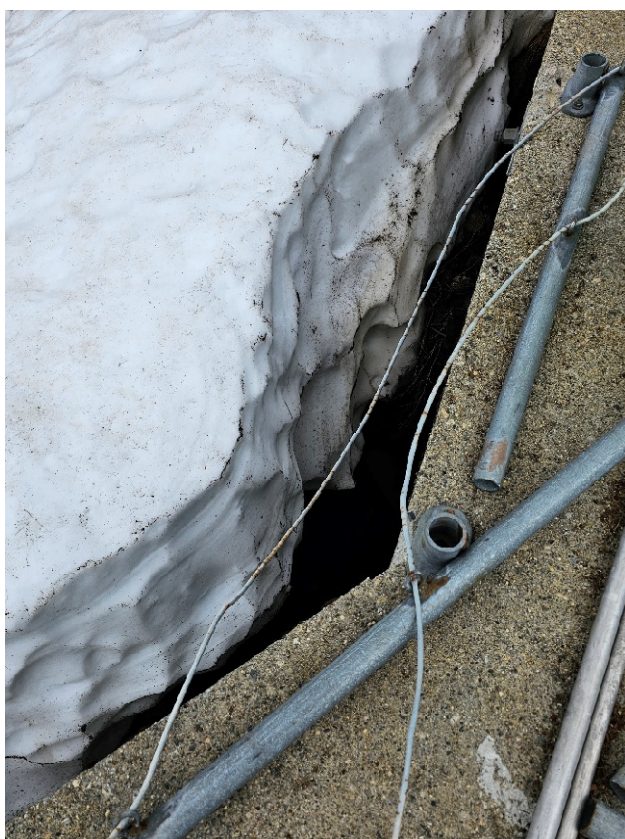
Plassering eksisterende minstevannsføringsrør
