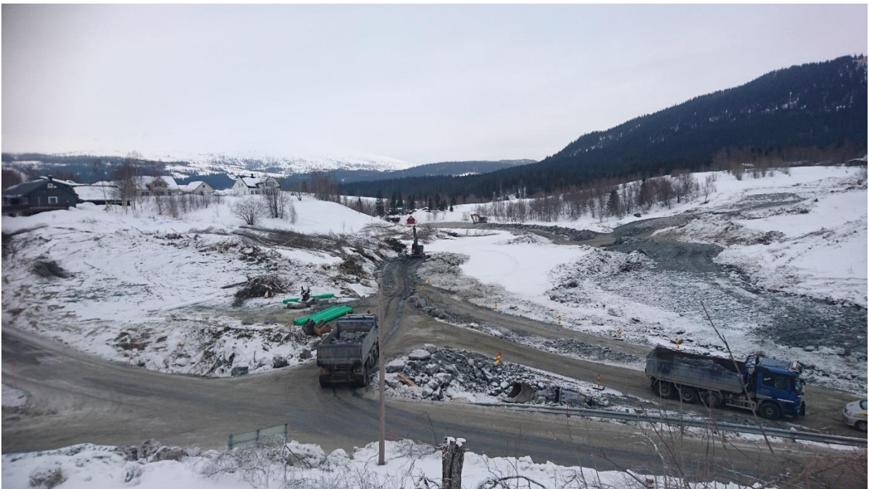
Figur: Begynnelsen av erosjonssikringen nedfor boligfeltet. Nesten ferdigstilt på andre siden Baåga. 23.02.2018
