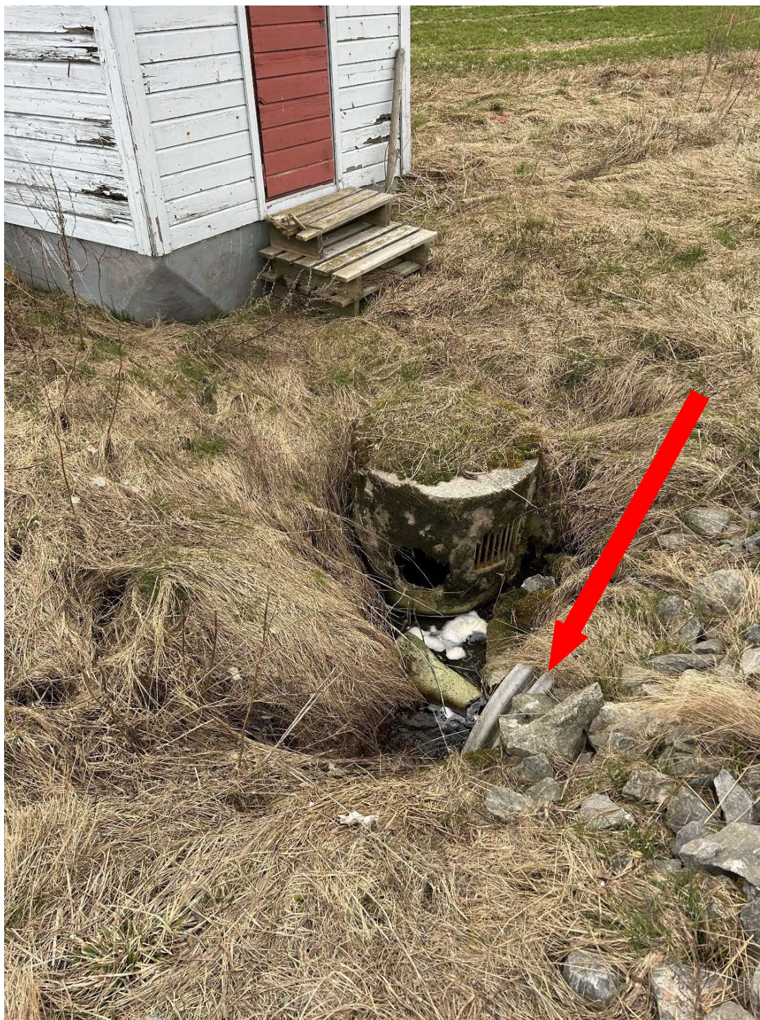
Figur 9 - Pumpestasjon og innløp til stikkrenne under Rv. 22. Rød pil peker på stikkrenna.
