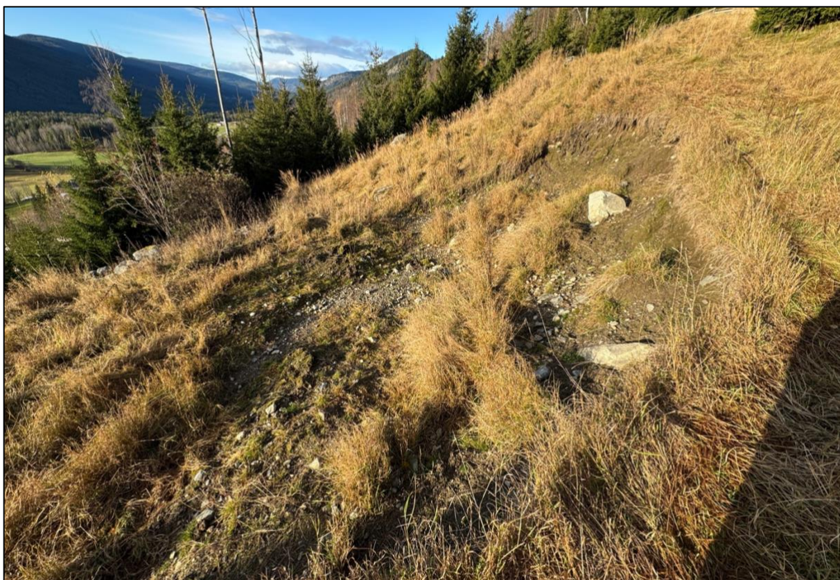
Figur 16: På befaring observerte vi en liten utglidning langs en skogsvei i østlig del av området. Vi antar utglidningen skjedde under ekstremværet Hans, (2023-08-08).
