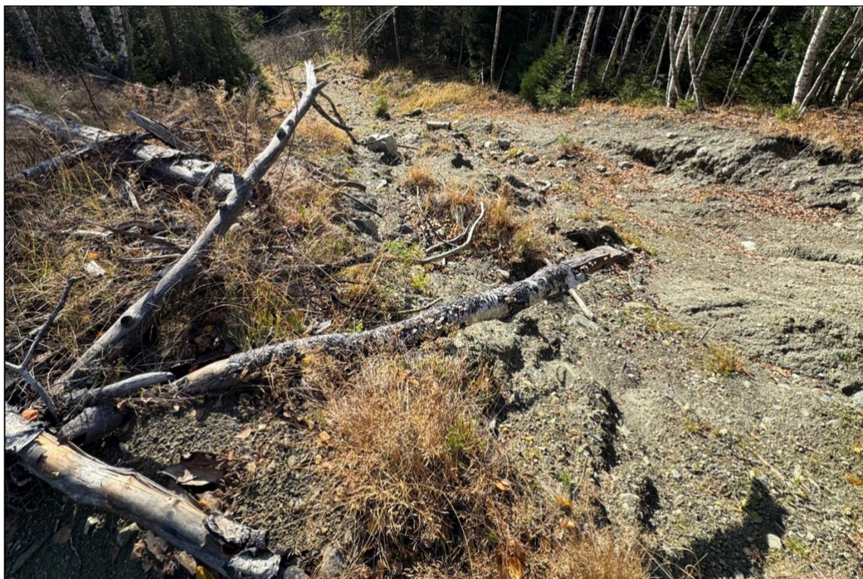
Figur 21: Bilde av øvre del av skredløpet til skredhendelse 2023-08-08D.
