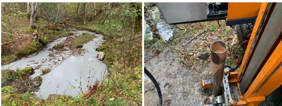
Figur 4: Foto fra lekkasje og fra foringsrør som ble brukt til injeksjon.
