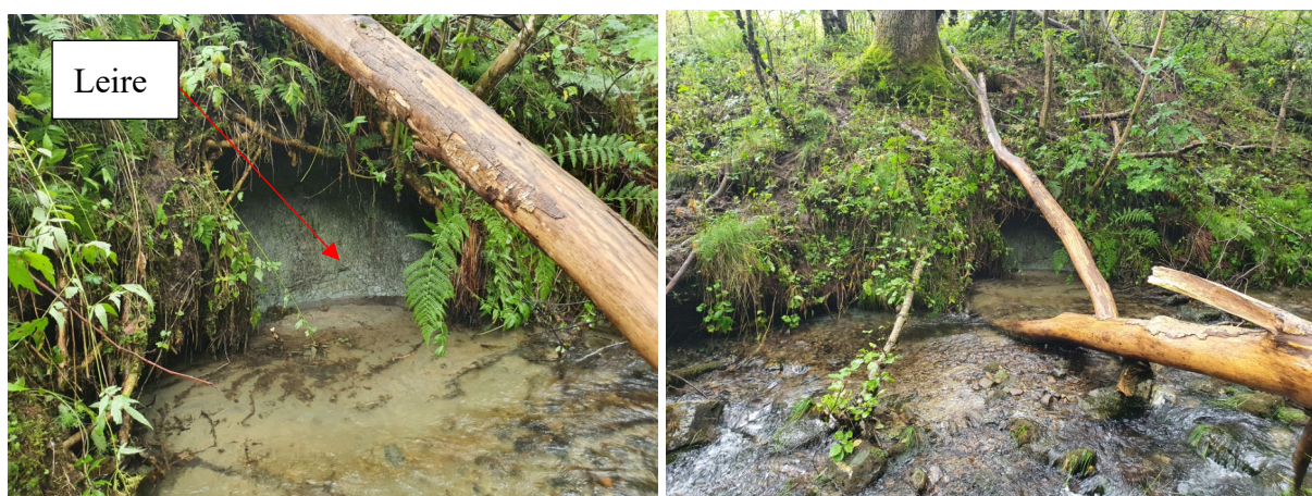
Figur 5: Erosjon i leire nedenfor borepunkt 2210.
