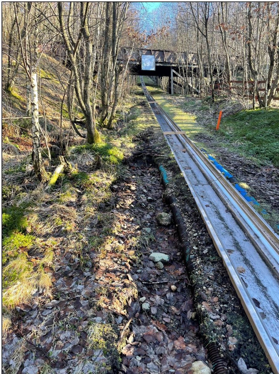
Figur 4: Bekk langs heisen til bobbanen, og noe erosjon i forbindelse med bekken. Bildet er tatt mot øst, ca. ved kote 150.
