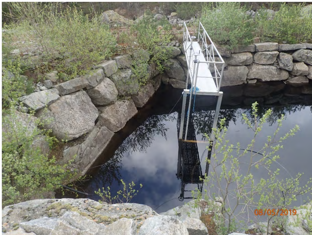
Bilde 4, tatt mot øst, viser inntaksarrangementet (haibur) for Døvik Kraft AS
