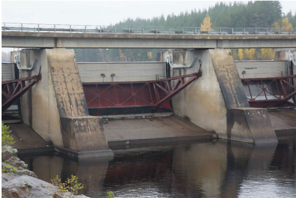
Bilde 5 Flomluke 4 i lukket posisjon (Foto Sweco)
