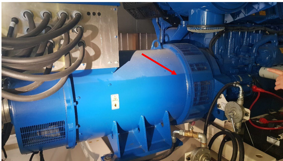
Bilde 17 Nødaggregatet druknet. Linjen oppe på generatordekselet viser skillet der vannet nådde på det høyeste, merket med rød pil (Foto DNV).
