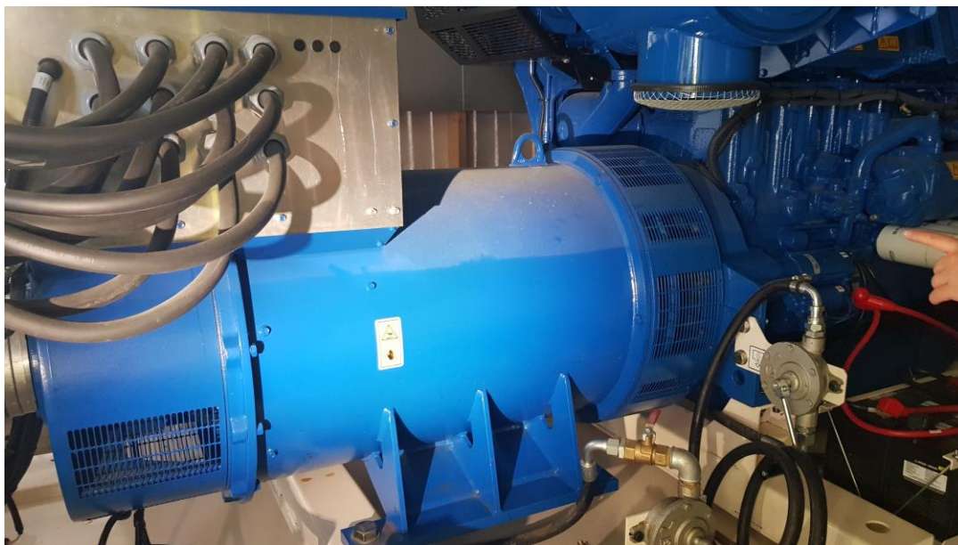
Vannstand, generatorsett – nødstrømsanlegg. Foto DNV
