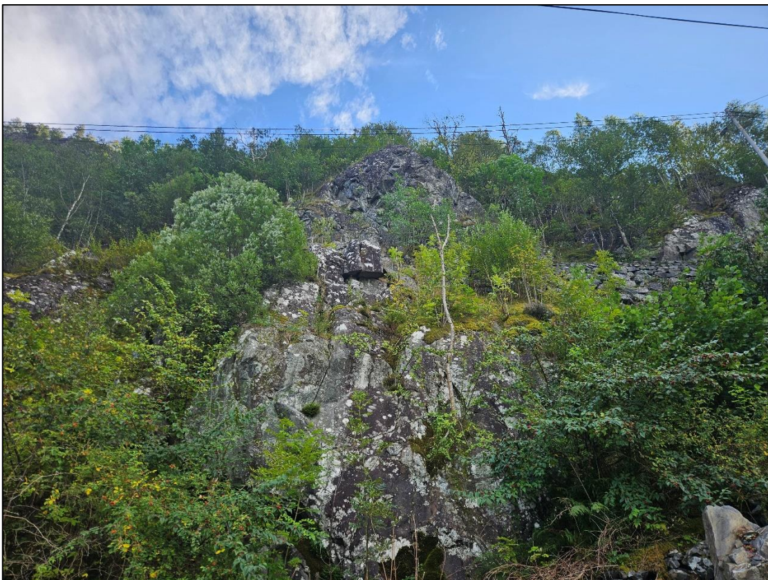
Figur 9. Avløst blokk med overheng mellom sjø og vei.
