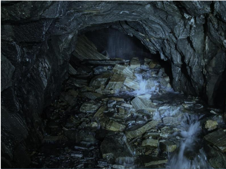
P195-200: Rasmasse ved bekkeinntak.
