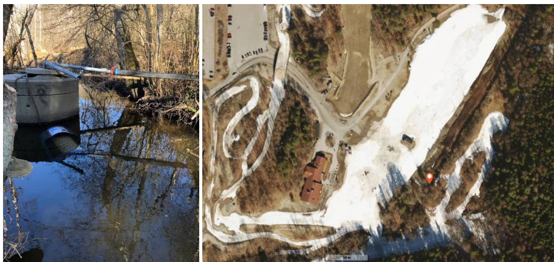
Figur 5. Vanninntaket i Ljanselva ved Skullerud ligger i en kulp øst for arenaen (rød pil) og består av en inntakskum midt i elveløpet (bildet til venstre).
