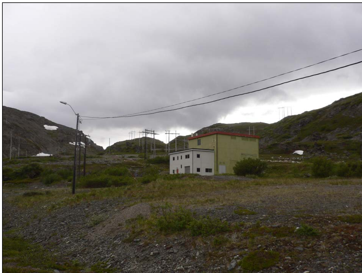
Figur 2.3. Kobbkroken transformatorstasjon. Foto: Gunnar Henriksen
