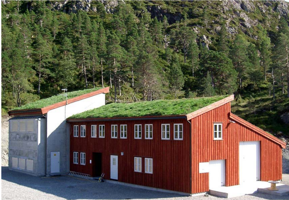
Figur 6.4 Transformatorstasjon og servicebygg (eks fra Hitra vindpark)
